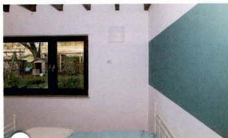
Die Wohnraumlüftung ist perfekt in den Raum integriert und fällt kaum auf.
